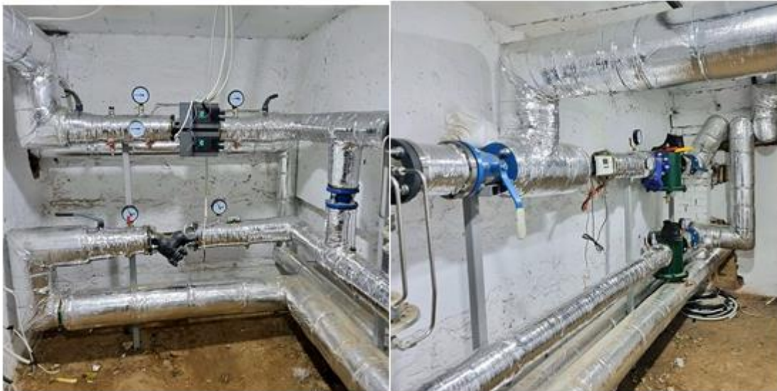
Рис. 12. ІТП багатоквартирного будинку
