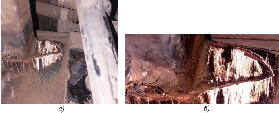
Рис. 6. Місце руйнування з'єднання каркасу основи з правою боковиною під дією магістральної втомної тріщини та корозії: а) загальний вигляд; б) місце тріщини (збільшено)
